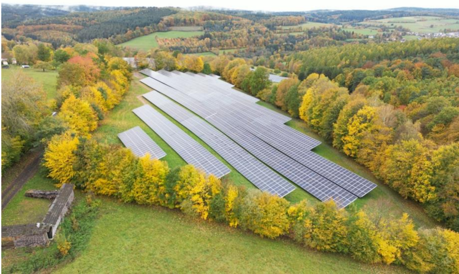
2023 Solarpark 8 MW, Pfaffenhausen am Königsberg geht ans Netz. ( Christian Damian )
