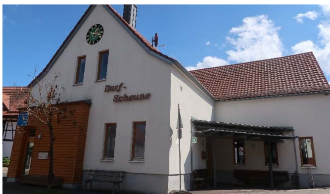
Abb. 20: Teil des Strategischen Sanierungsbereichs: Fassade des Dorfgemeinschaftshauses
