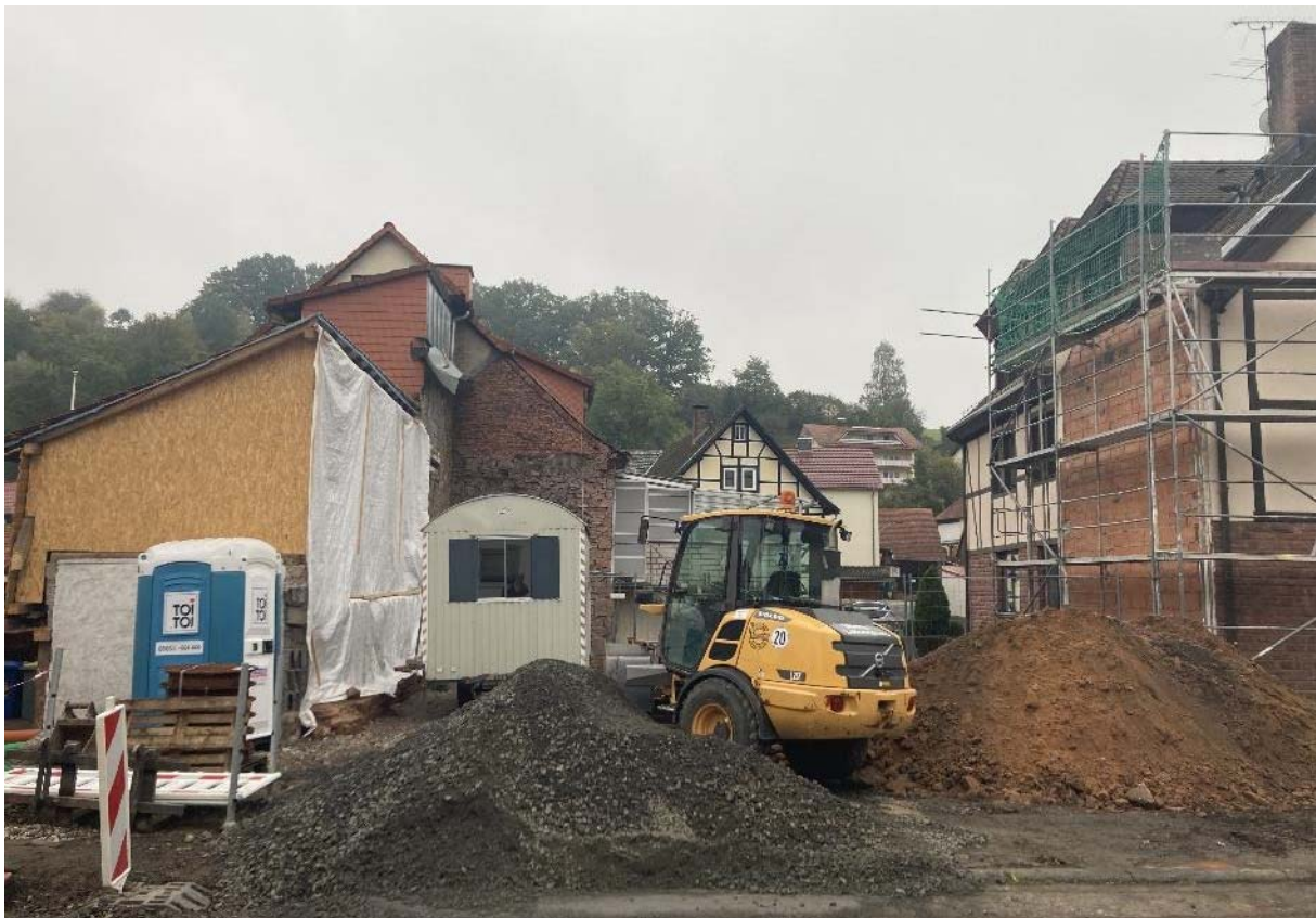
Abb. 22: Abriss mit Umnutzungspotential in kompakter Baustruktur (Oberndorf)
